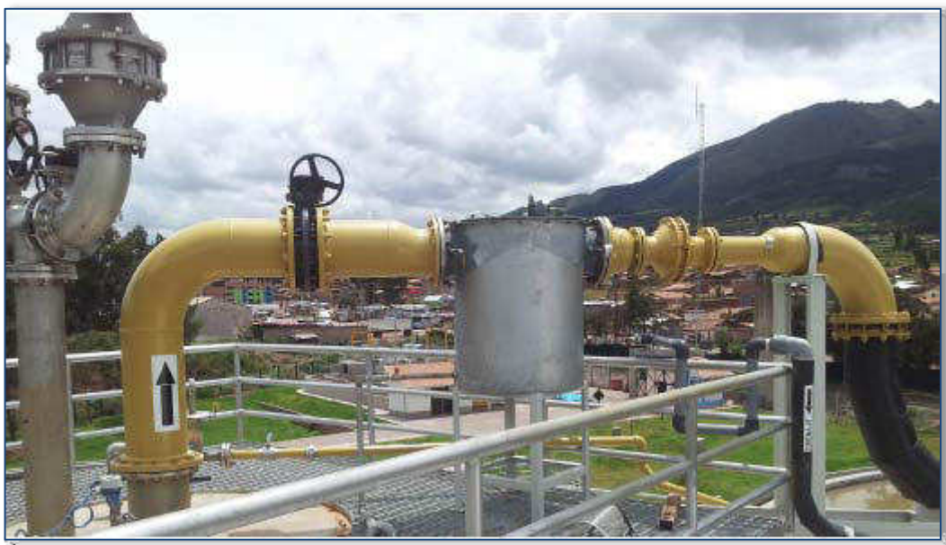
Figura 4.6 - Captação do biogás no topo do digestor. Fonte: Silveira et al. (2015)
