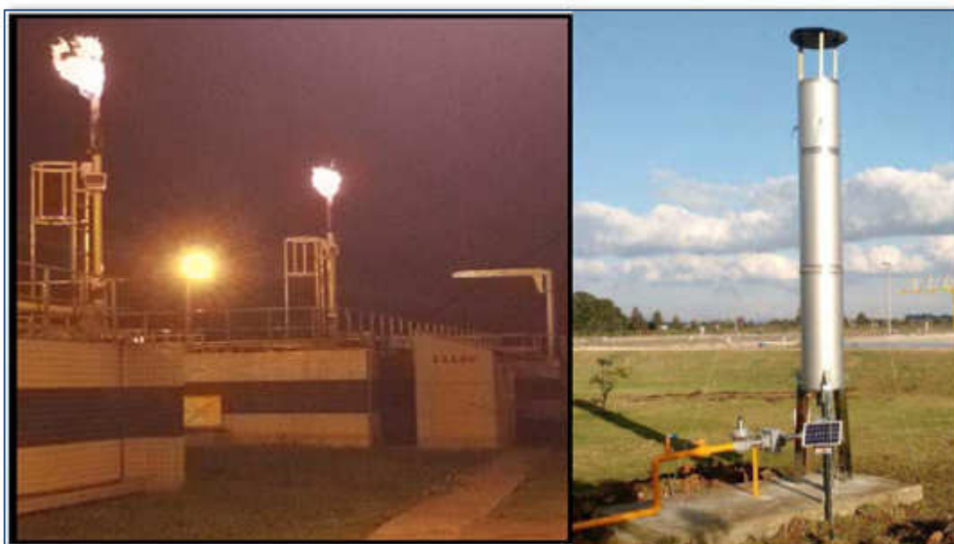
Figura 5.5. Queima do Biogás em “Flare”. Fonte: Possetti, 2016
